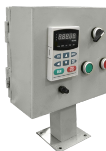
Painel com Inversor de Frequência
